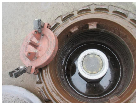
(AQGP-22 & 23) Dust Cap- broken.
