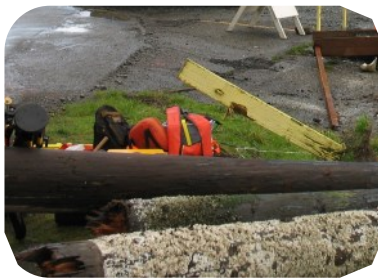
Broken Creosote Piling
