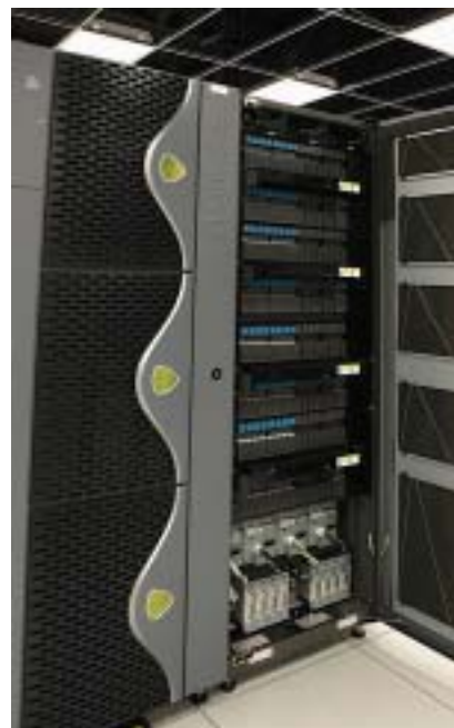
Hitachi TagmaStore USP Tier-1 storage array
