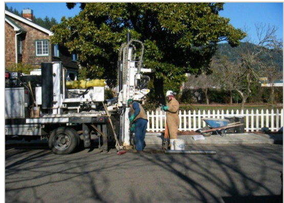
Recolección de muestras de suelo junto a un tanque de almacenamiento subterráneo con fuga.
