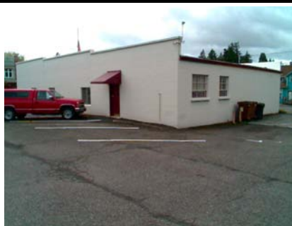
NE Falling Hazard
