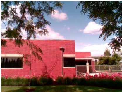
NE Falling Hazard
