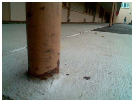
SE Falling Hazard
