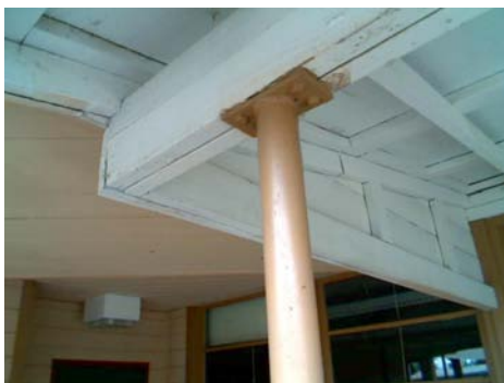
NE Falling Hazard
