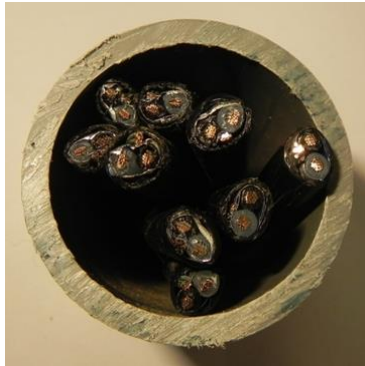
1 1/2" conduit w/9 loop feeder cables Exceeds NEC max fill Exceeds ODOT max fill
